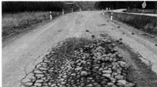
ROZBITÉ SILNICE. Obce trápí v souvislosti s výstavbou dálnice poničené cesty od nákladních souprav. Foto: Martin Trškal
